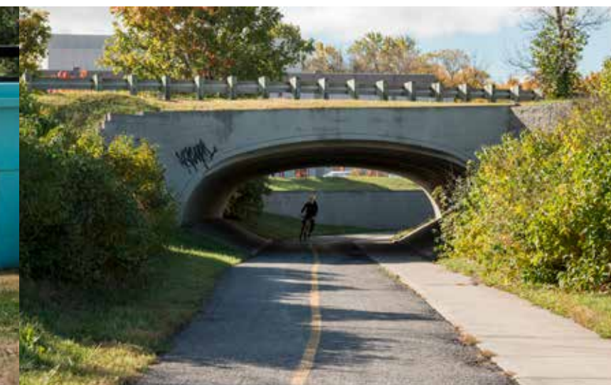
Tunnel pour un trottoir et une piste cyclable, sous le boul. Notre-Dame à Laval
